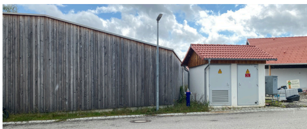
Beispiel bestehende Trafostation, Foto Franz Schröck
