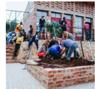
3. Baustellenphase im Februar/ März mit Studierenden der TU München, der Hochschule Augsburg und der Martyrs University, Uganda, Innenausbau und Außenraumgestaltung
