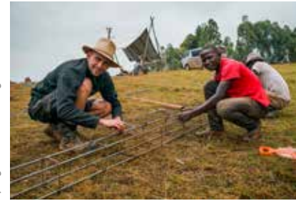
Binden der Bewehrungsseisen für den Ringanker Tying the armouring irons for the ring beam
